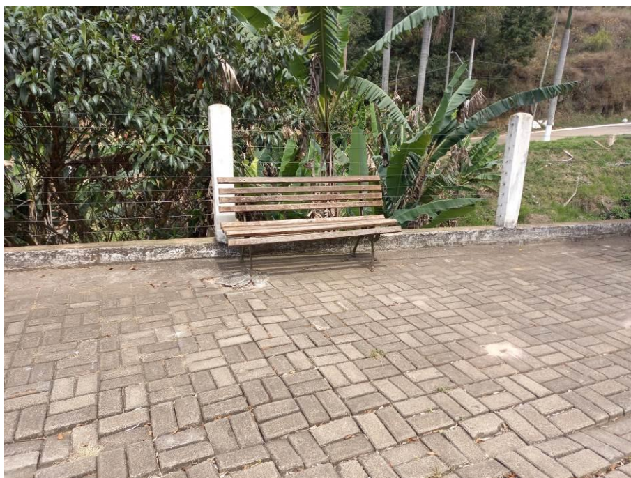
Foto 15: Banco de madeira com desgastes na camada de verniz. Autoria: Alexandra Sales | Data: 16/09/2025
