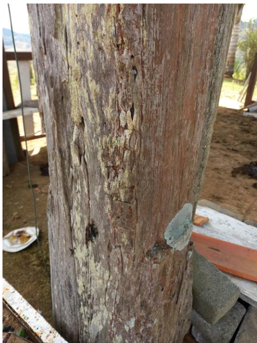
Fotos 04: Base com ressecamento, fungos, líquens, frestas e furos causados por xilófagos. Autoria: Alexandra Sales | Data: 16/09/2025
