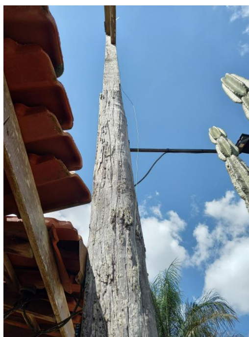
Fotos 03: Tronco com frestas, ressecamento, fungos e furos causados por xilófagos. Autoria: Alexandra Sales | Data: 16/09/2025
