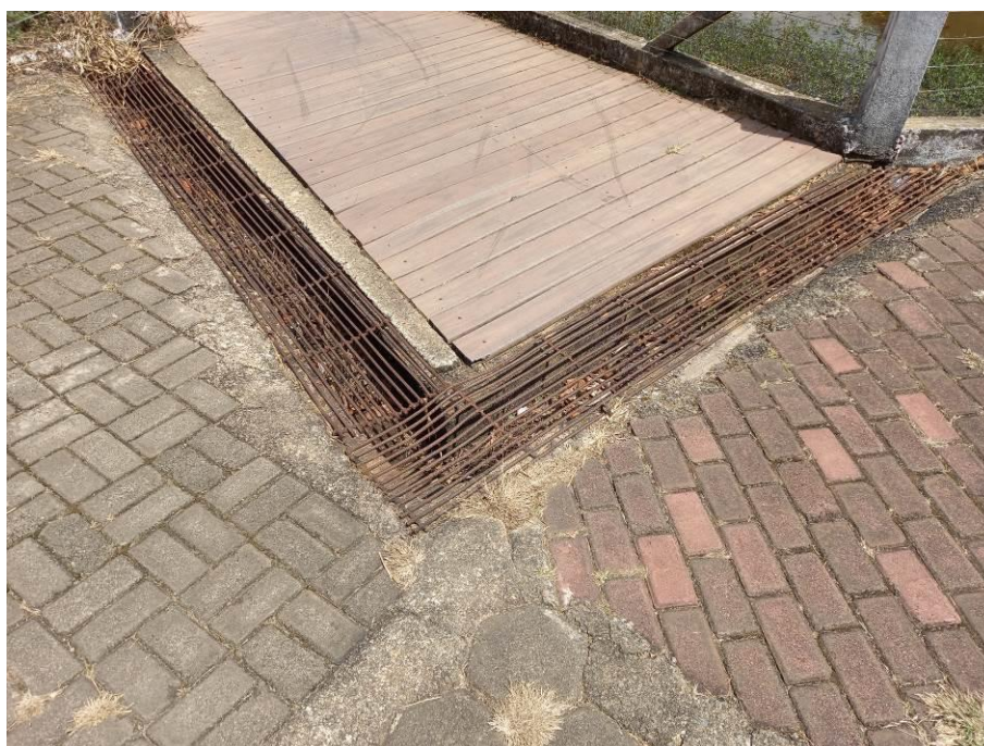
Foto 06: Oxidação, deformações, vegetação invasora e sujidades na grelha.
