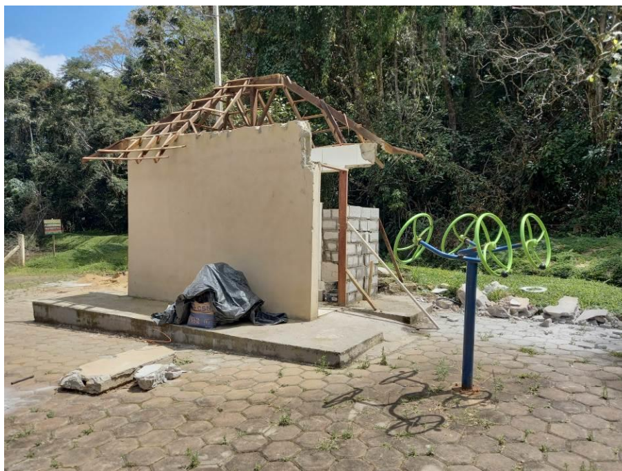
Foto 22: Vista da edificação que abriga os banheiros parcialmente destruída após queda de uma árvore sobre a mesma.
