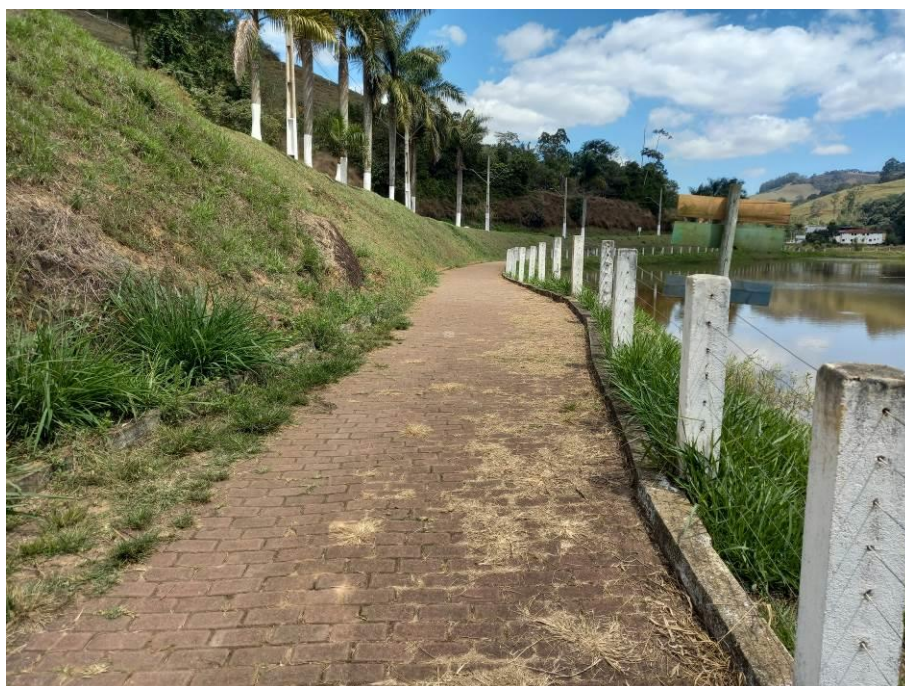
Foto 14: Trecho onde há vegetação invasora no piso. Autoria: Alexandra Sales | Data: 16/09/2025
