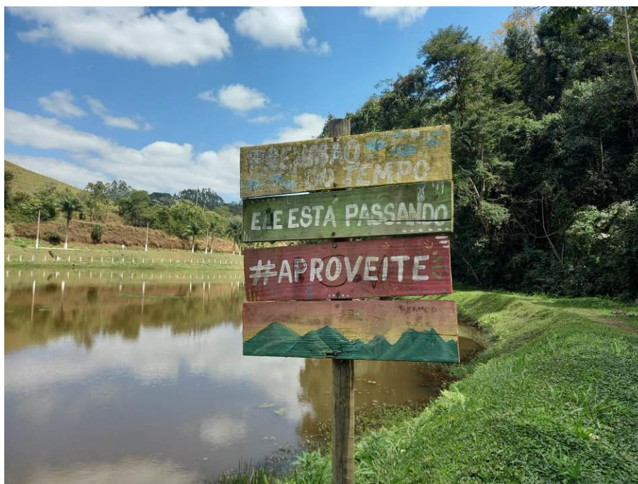
Foto 05: Placas de madeira com esmaecimento e perdas nas camadas pictóricas. Autoria: Alexandra Sales | Data: 16/09/2025
