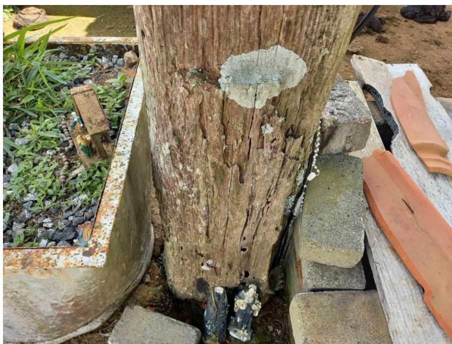
Foto 06: Base do Cruzeiro com danos gerais. Autoria: Alexandra Sales | Data: 16/09/2025
