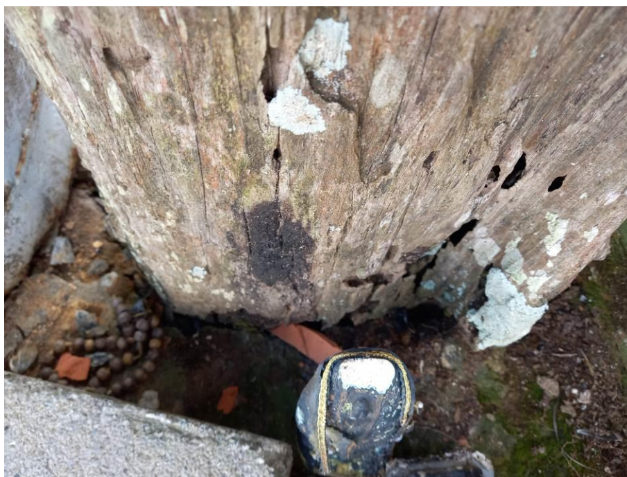
Foto 07: Detalhe da base do Cruzeiro com apodrecimento causado pela umidade absorvida do solo, além de perdas causadas por xilófagos, fungos e líquens.
