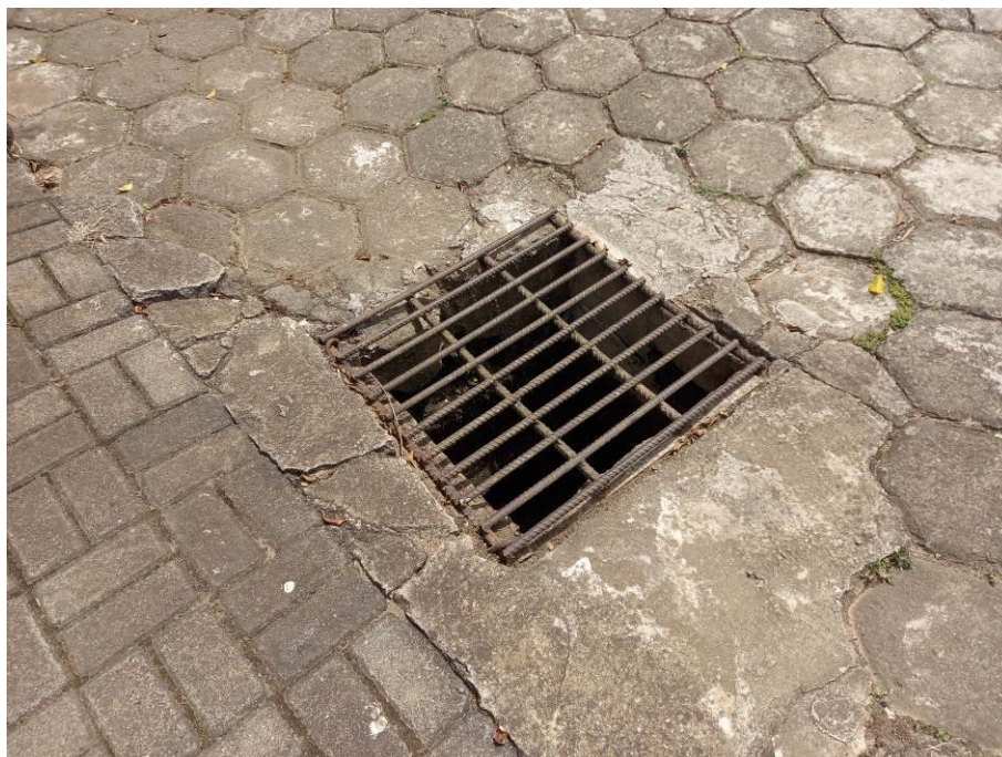
Foto 07: Grelha em bom estado. Autoria: Alexandra Sales | Data: 16/09/2025
