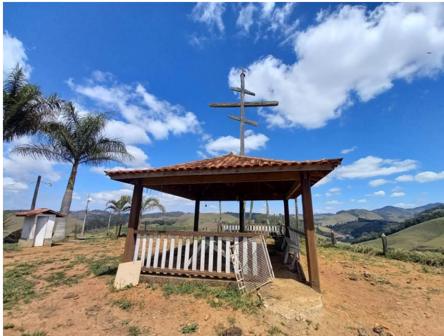
Foto 09: Vista do quiosque com o portão danificado. Autoria: Alexandra Sales | Data: 16/09/2025
